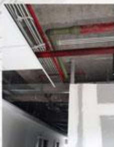
INSTALASI PIPA PEMADAM
