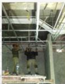
INSTALASI PIPA PEMADAM
