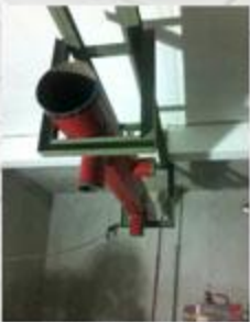
INSTALASI PIPA PEMADAM
